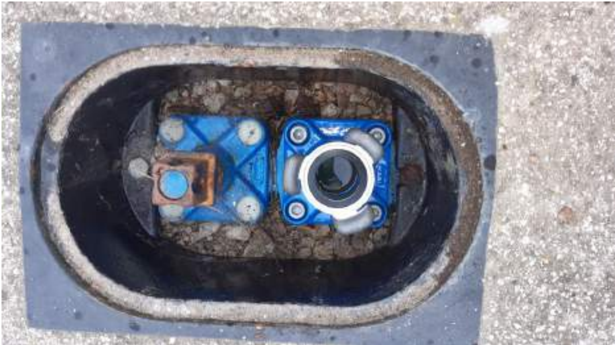
Fotografía. 1. Boca de riego con racor Barcelona.
